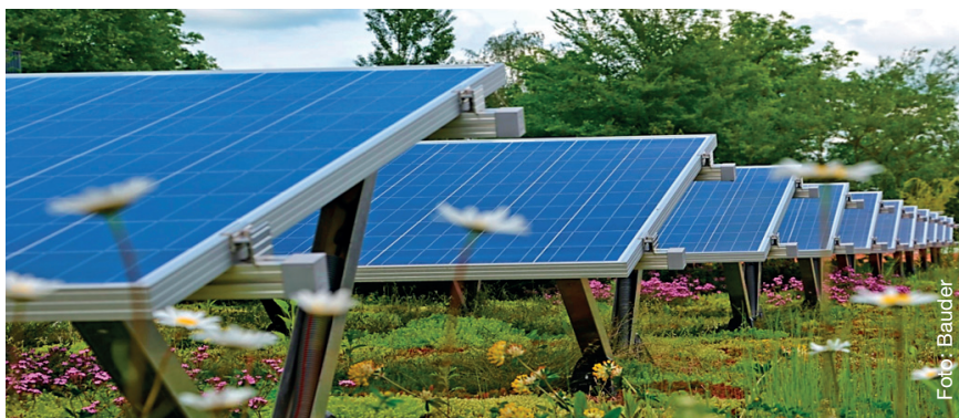
BauderSOLAR Gründach UK: Photovoltaik und Dachbegrünung passen erstaunlich gut zusammen.
