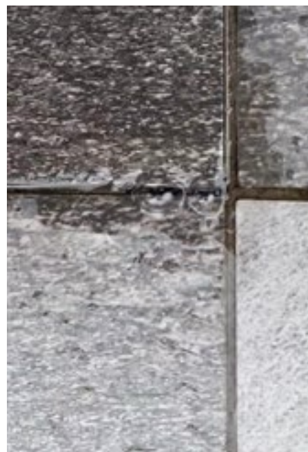
Eindringendes Wasser und Staunässe sorgten unter der Terrasse für Folgeschäden
