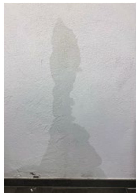
Ein Wasserschaden im Keller durch einen Abdichtungsfehler an der Gebäudeaußenwand
